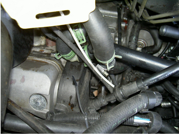
Eingebautes Ventil mit Ausgang zur Pumpe
